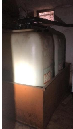
Abbildung 18: Bsp. Kellerraum: Heizungsanlage
