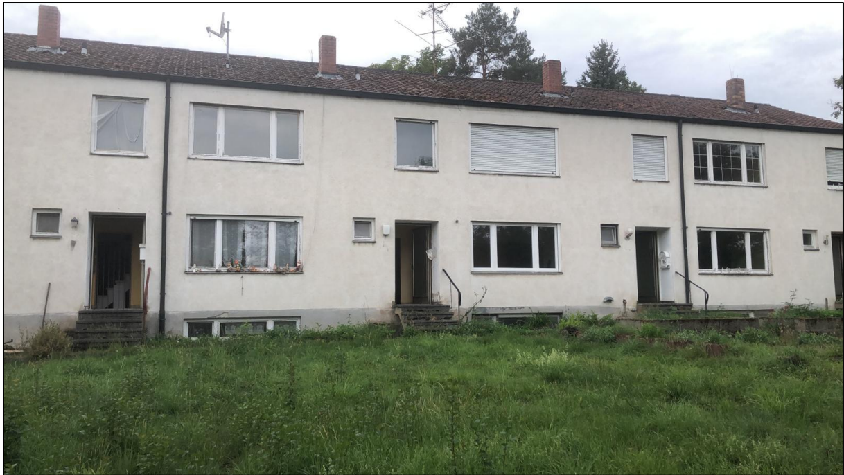
Abb. 2: Abrissreife Reihenhäuser mit ihren vorgelagerten ehemaligen Gärten.
