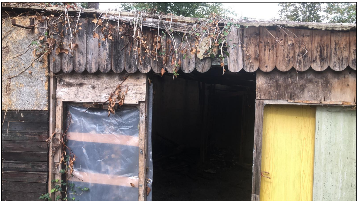
Abb. 3: Abrissreifer Schuppen auf der Rückseite der Reihenhäuser
