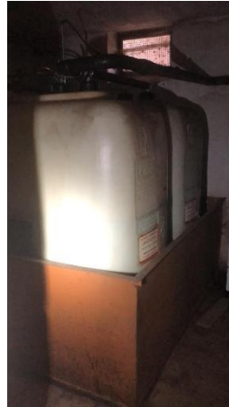
Abbildung 18: Bsp. Kellerraum: Heizungsanlage
